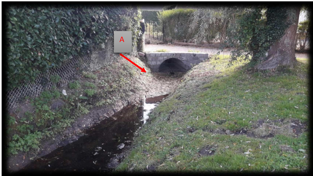
Point de rejet rue St Germain - Bellengreville
